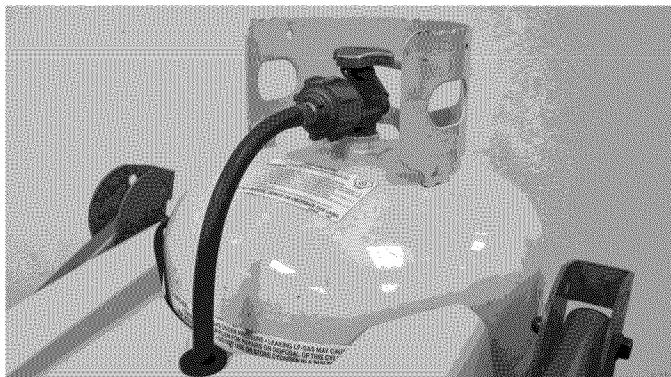
Figura 10 - Tanque de posición
